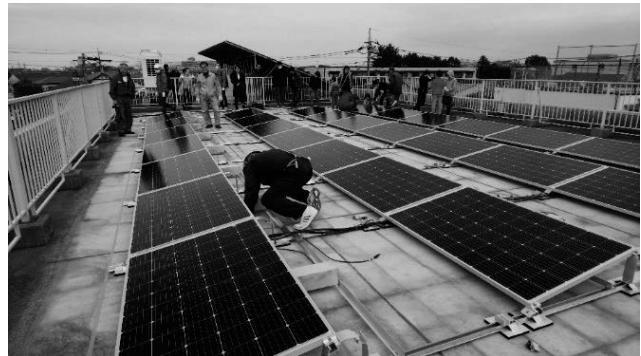
[第1号市民発電所の写真]
