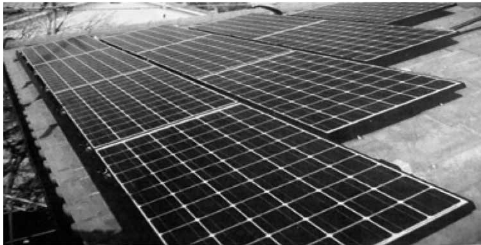
[松戸市土田宅住宅用太陽光発電システムの南側全景]
